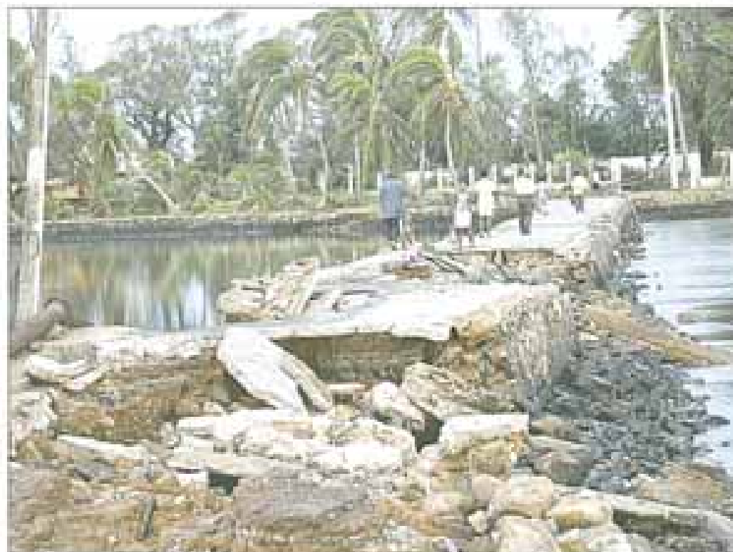
Un hôtel menant à un complexe hôtelier à Fénérive-Est, gravement endommagé.
